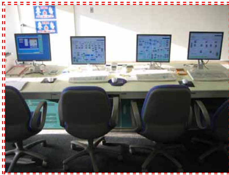
前新田浄水場 中央監視室
